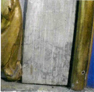
Coulures d'eau, côté gauche de la niche centrale
